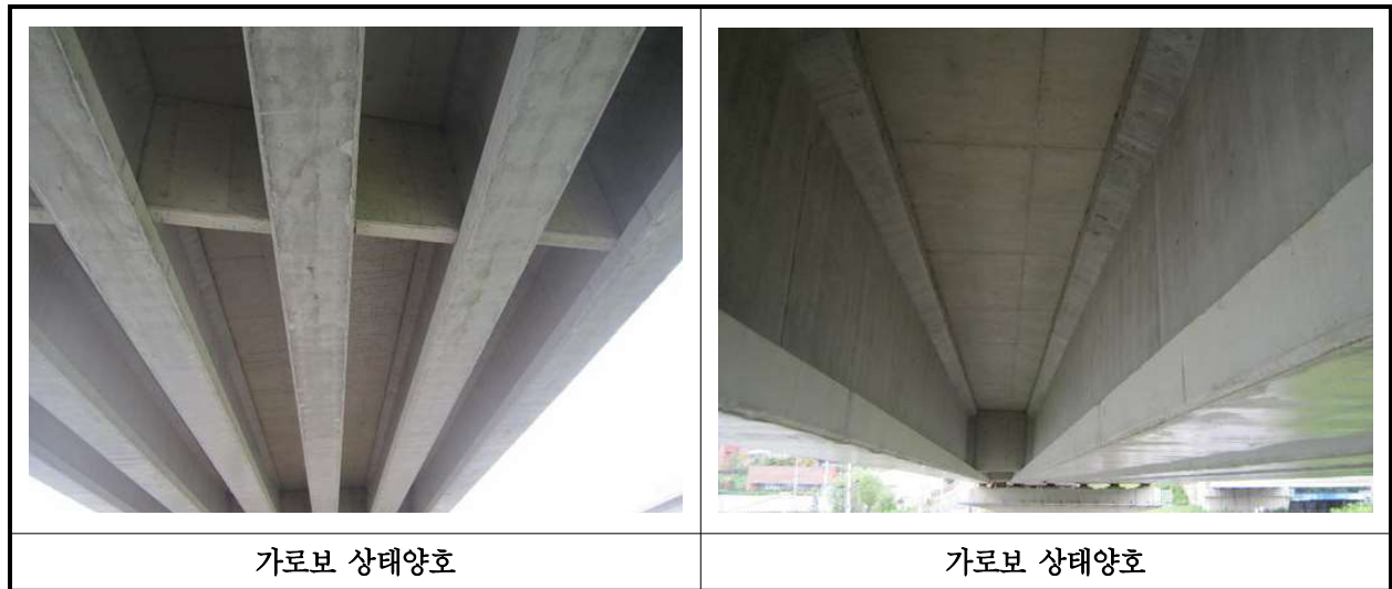
【사진 30.3.7】 가로보 손상현황
