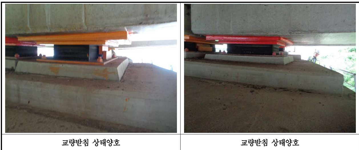
【사진 30.3.13】 교량받침 손상현황
